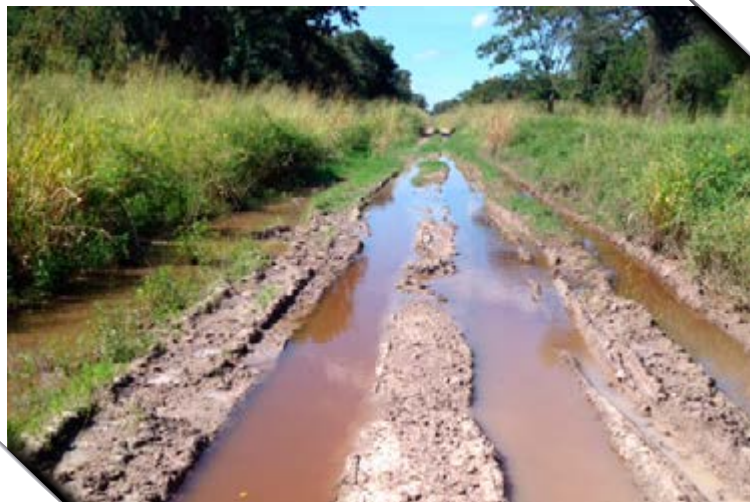
Camino en mal estado.
